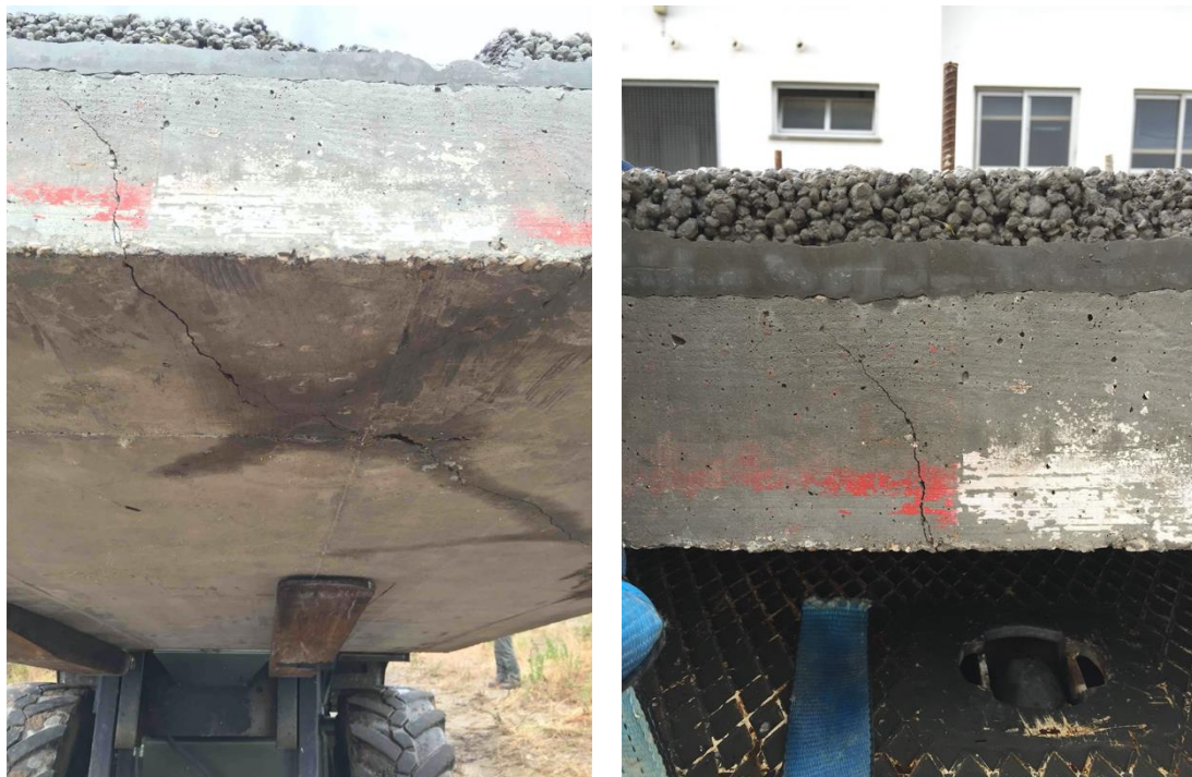
Figura 28 – Fissura provocada pela queda parcial da laje
