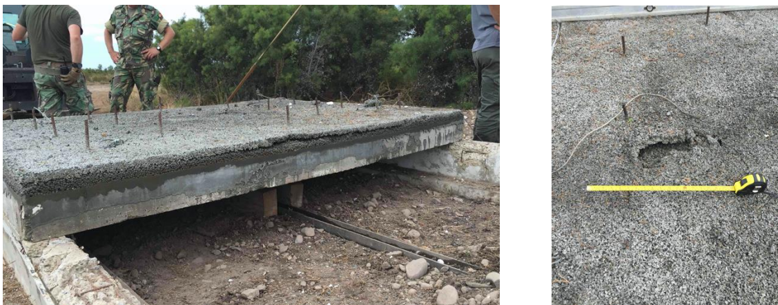
Figura 62 - Destacamento da camada de RuC (à esquerda) e perda de secção (à direita)
